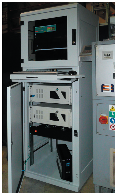
Skříň se dvěma počítači systému vizuální inspekce. Počítače jsou navzájem propojeny 1 Gb Ethernetem
